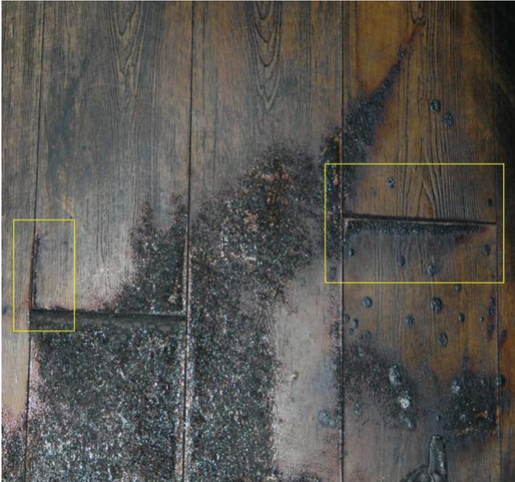
[사진 45] 유류에 의한 틈새의 연소 패턴 20)
