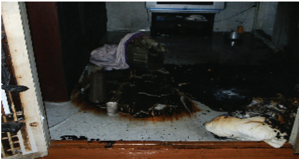
[사진 42] 연소촉진제의 살포에 의한 바닥의 소손상황
