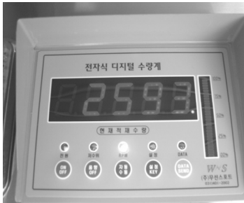
펌프 조작반 수량계
