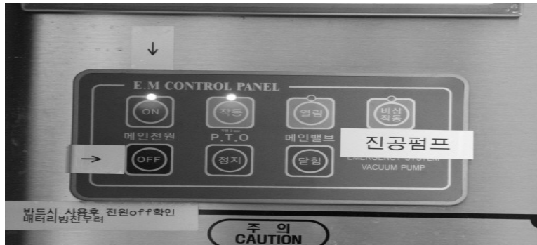
펌프조작반에 설치된 비상작동 조작스위치
