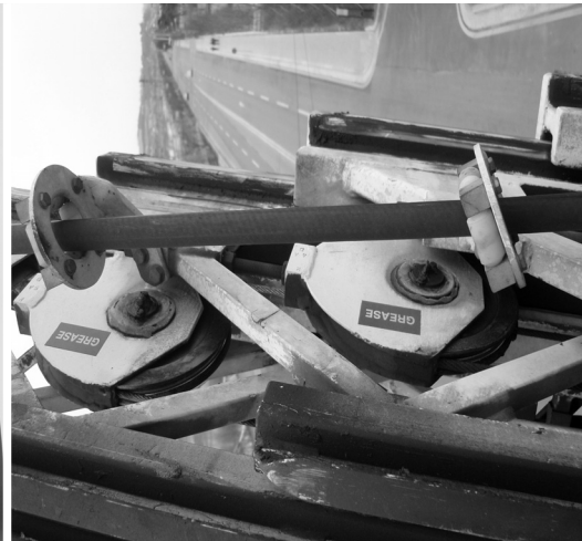
※ 롤러의 그리스 주입 및 손상여부 확인
