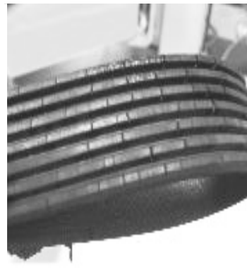
팬벨트 안쪽 균열
