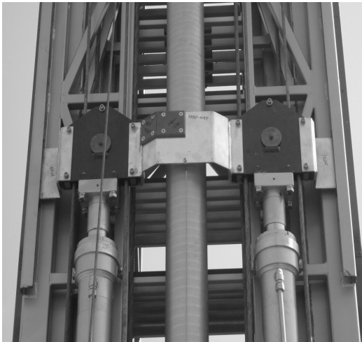
※ 신장실린더 오일 누유 및 신장 롤러 확인
