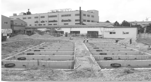
[그림 86] 탱크전용실에 설치된 지하저장탱크
