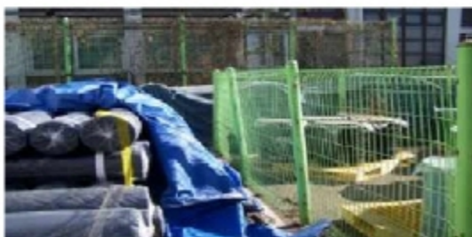
[경계 울타리 파손 및 보유공지 미 확보 예시]
