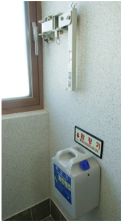
<완강기 설치 상태>
