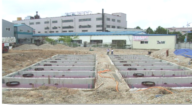
[그림 1-82] 탱크전용실에 설치된 지하저장탱크
